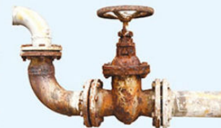
Figura 4.40 Cuando una tubería se daña por la oxidación ocasiona serias pérdidas económicas, pues pueden provocarse fugas de gas, agua potable o aguas residuales, entre otras.
